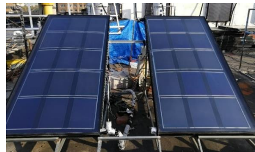
Fig 2 Actual setup of two a-Si PV/T systems
